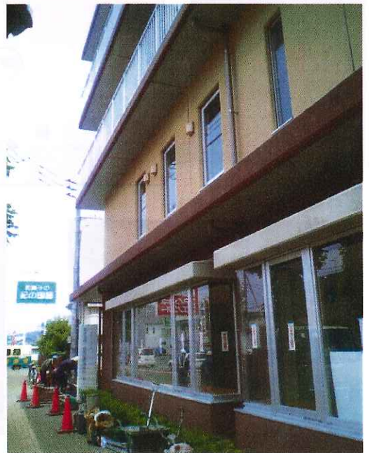
写真: 【 開設に向けて工事が進む「あきる台在宅医療福祉センター」 】
